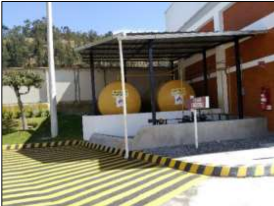
Foto N° 33. Instalación para el manejo de combustibles.
