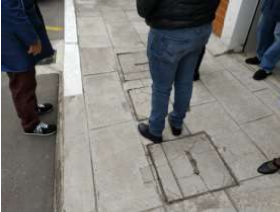
Foto N° 22. Tapas del sistema de funcionamiento de las trampas de grasa.
