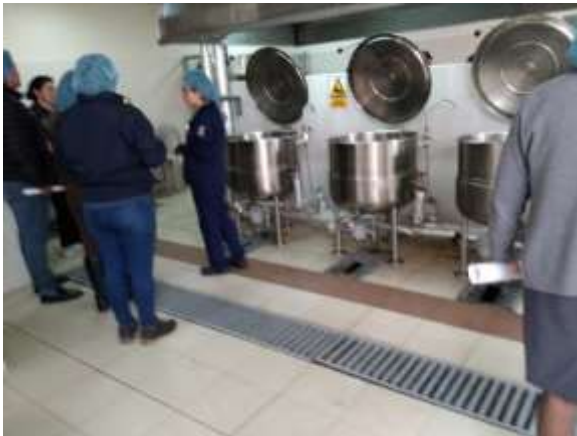
Foto N° 17. Instalaciones de cocina se puede apreciar las marmitas y en el piso rejillas para manejo de área húmeda.
