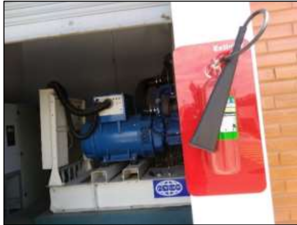
Foto N° 37 Equipamiento del Área de generador de energía.
