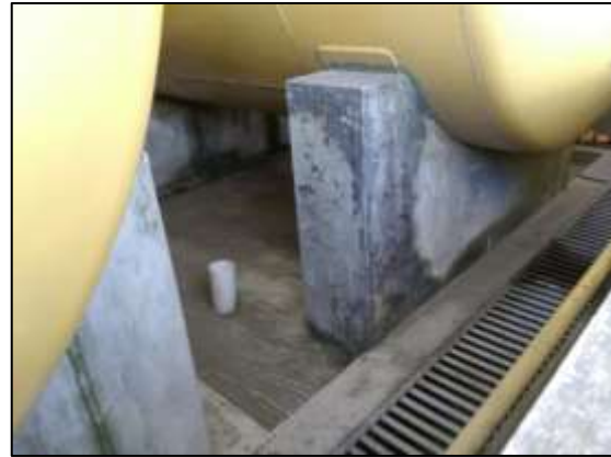
Foto N° 34. Equipamiento interno dentro del área de manejo de combustibles.
