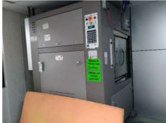
Foto N° 14. lavadora industrial en el área de lavandería.
