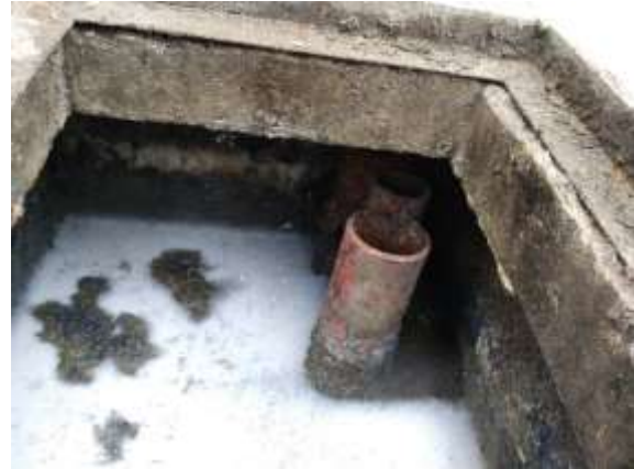
Foto N° 23. Inspección de funcionamiento de las trampas de grasa
