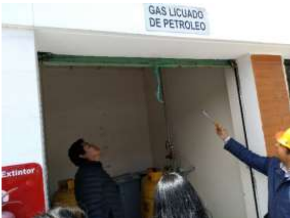
Foto N° 15. Área de almacenamiento de GLP
