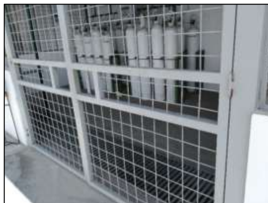
Foto N° 35. Gases medicinales dentro del área de central de gases.
