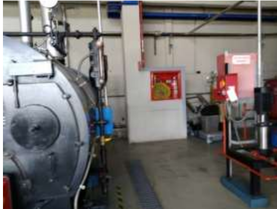
Foto N° 36. Equipamiento del área de calderos.
