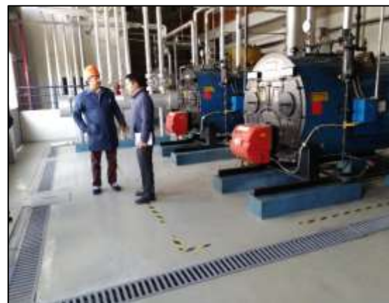
Foto N°12. Área de instalación de los calderos
