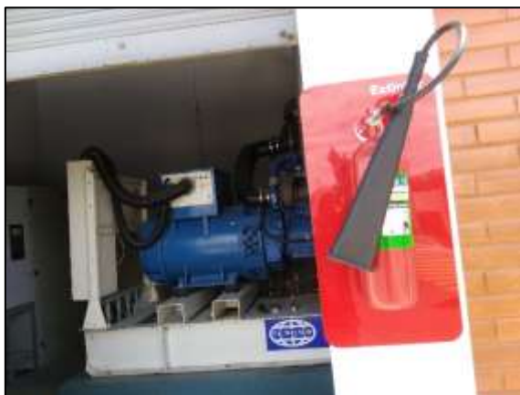
Foto N° 11. Área del generador Eléctrico
